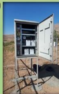
نصب نابلوی UPS برکت
